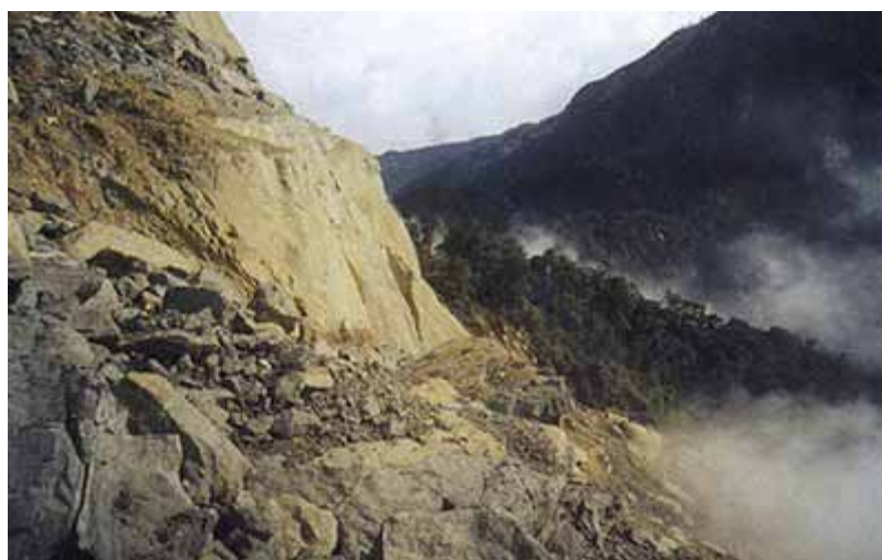
圖 2 九二一震災災後安定灣損壞狀況
